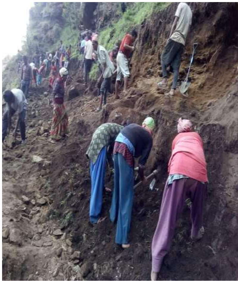
वडा नं. ४ मध्य पहाडी जीरो पोईन्ट देखि सहडे सडक निर्माण मा खटिएका श्रमीक सदस्यको दृश्य ।
