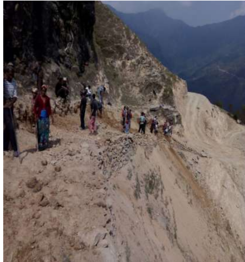
चित्र नं. ४ : वडा नं. २ रुम डाँडामा बाटो निर्माण कार्य हुँदै गरेको दृश्य ।
