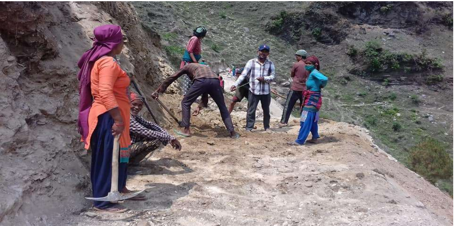
चित्र नं. २ : वडा नं. १ चिसी खोल देखि दाल्का पानि बाटो निर्माण कार्य हदै गरेको दृश्य ।
