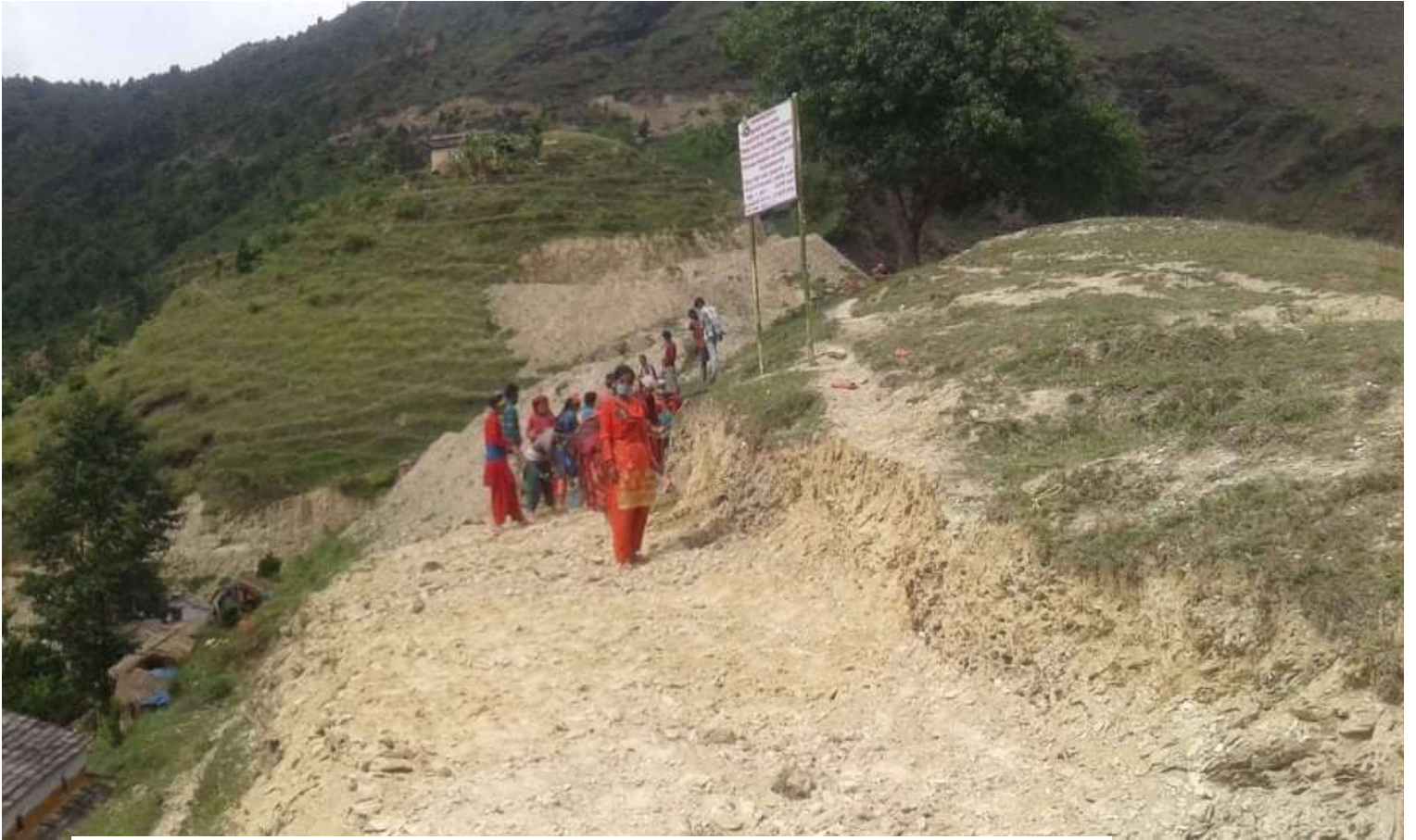
चित्र नं. ३ : वडा नं. १ चिसी खोल देखि दाल्का पानि बाटो निर्माण मा सूचना पाटि सहितको दृश्य ।
